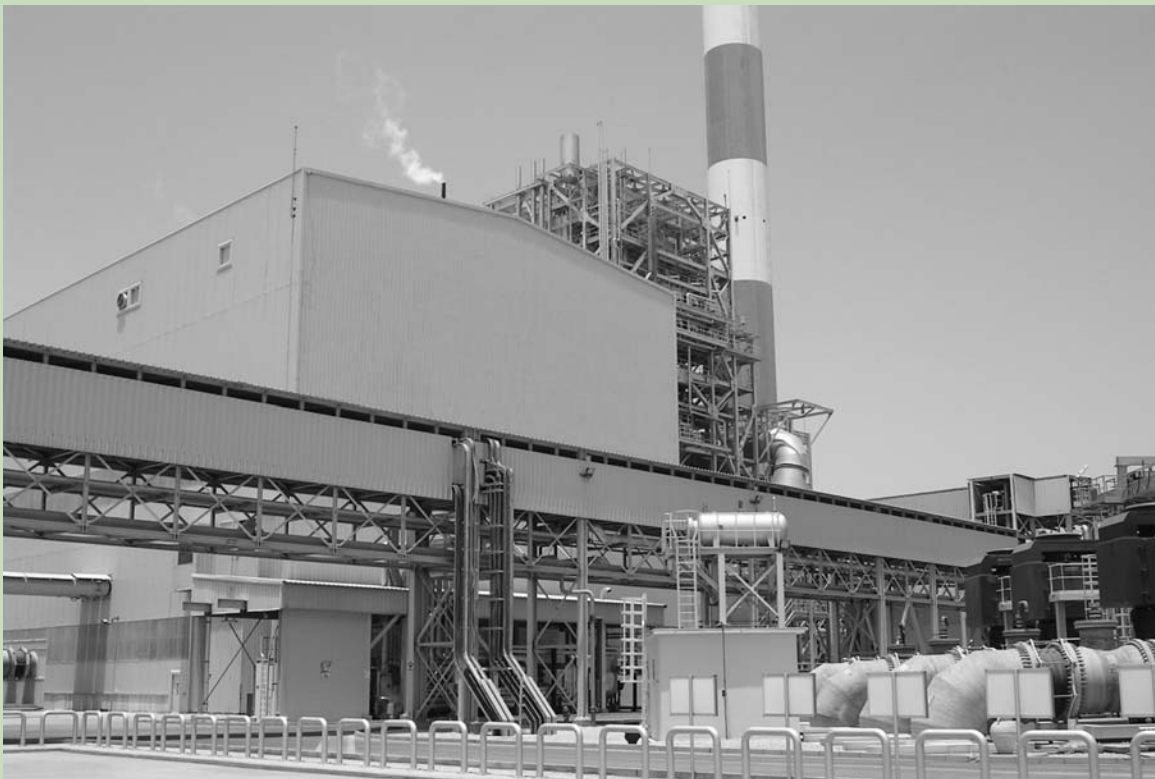
Power plant in Egypt. Photo courtesy of Jouni Martti Eerikainen.
