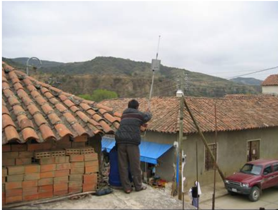
Figura 7: Instalación de un punto de acceso (malla) en el telecentro, Sopachuy (La antena omnidireccional está situada sobre la malla)
