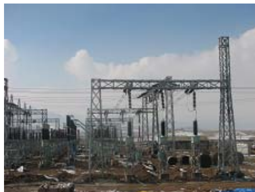
نمایی از سب استیشن شمالی برق در شهر کابل، که اخیراً بازسازی گردیده است.
