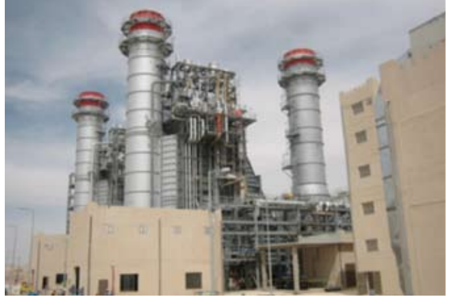
محطة شرق عمان للطاقة بقوة ٣٧٠ ميغاوات هي أول محطة خاصة لإنتاج الكهرباء في الأردن.
