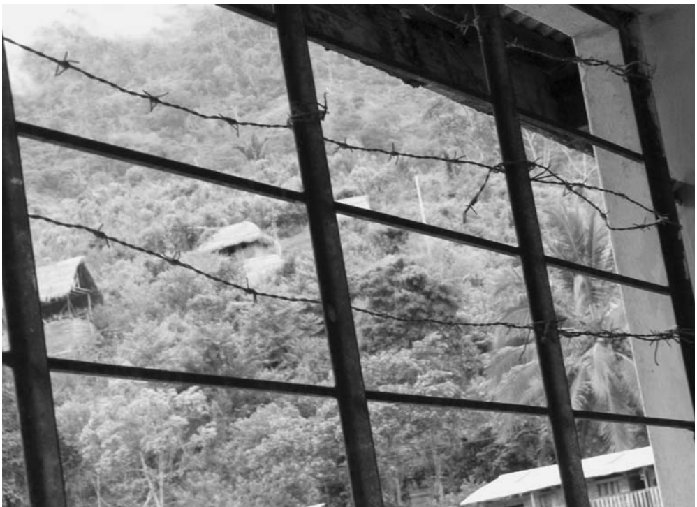
Ventanas sin vidrios ni mallas, Los Ángeles de Ubiquirri. (Foto: Andrés Figallo)
